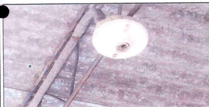
Foto 5: plafoneras en mal estado
